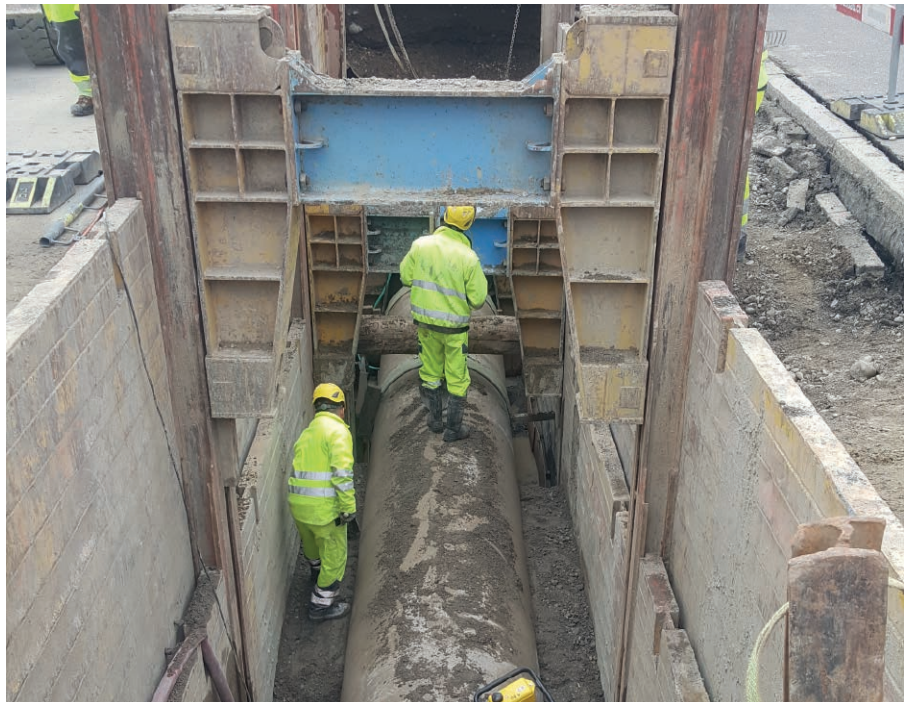
Offenes Grabensystem in der Albisstrasse
