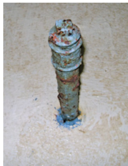
Rostbefall bei den ca. 10 Rohrstützen.
